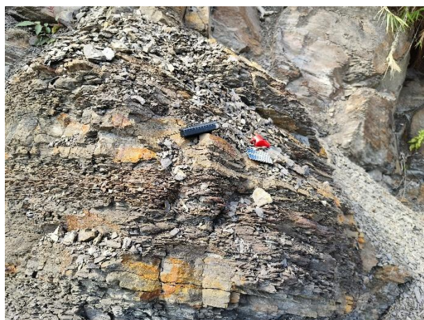
長枝坑屬砂頁岩互層，頁岩層極多薄層互層，岩體非常破碎。
