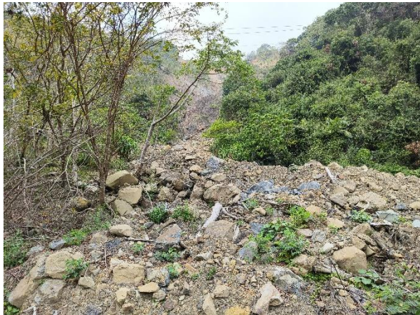
崩落的岩體經流水作用形成土石流扇狀堆積，照片可見砂岩及更破碎的硬頁岩。
