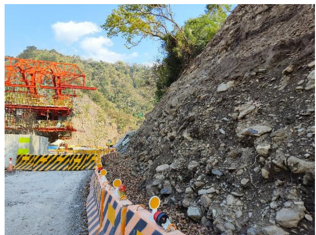
玉穗溪左岸邊坡尚留有古土石流痕跡，新建橋梁建於破碎岩層之上。
