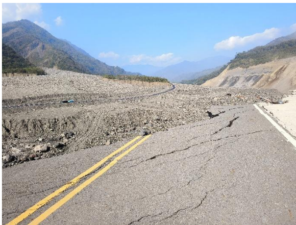
明壩克露橋舊台 20 線公路被沖毀，路基遭洪水掏空。
