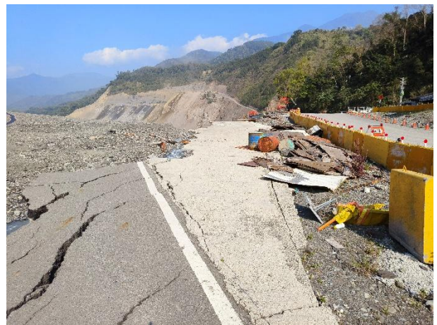
掏空的路基上方有許多近乎平行的龜裂痕跡，右側為新建的台 20 線公路。
