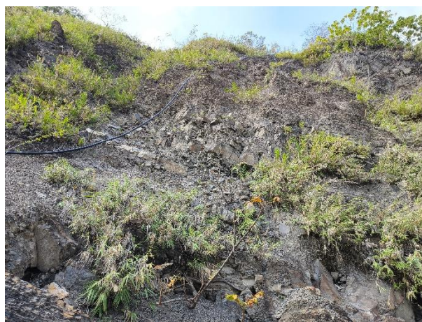
曲流凹岸為陡峭的侵蝕坡，上層地層可發現表層風化嚴重，應是二次堆積形成。
