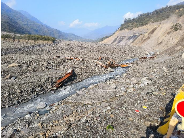
明壩克露橋便橋於 2024 年遭凱米颱風 洪水土石流沖毀，尚遺留在河床。
