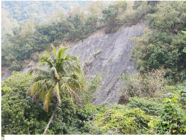
北寮頁岩與長枝坑層交界處地質破碎，路面常發生陷落，下方即為平溪斷層。
